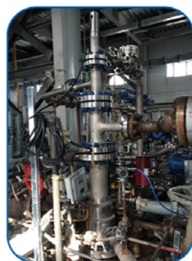
水煤浆组合烧嘴 Combined burner
