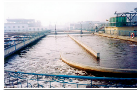
张家港东沙化工污水处理工程 Zhangjiagang waste sewage treatment project
